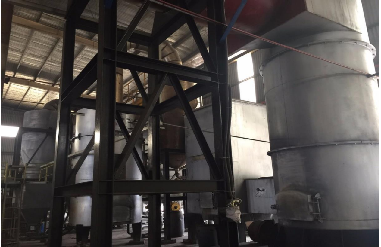
Hệ thống xử lý khí thải lò đốt 2.000kg/h
