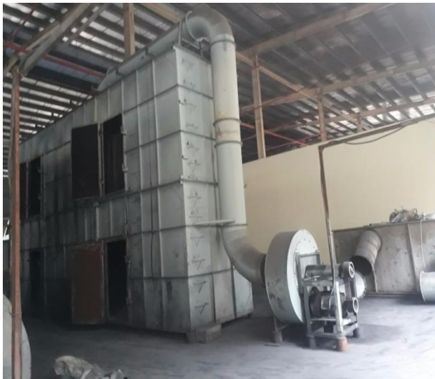
Hệ thống xử lý bụi chì
